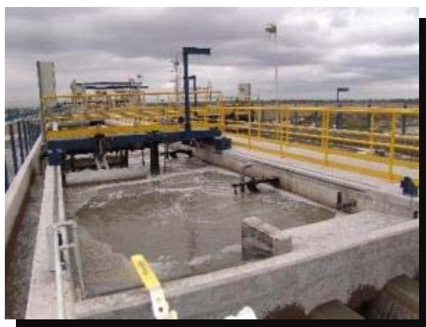
* Planta de tratamiento de agua
